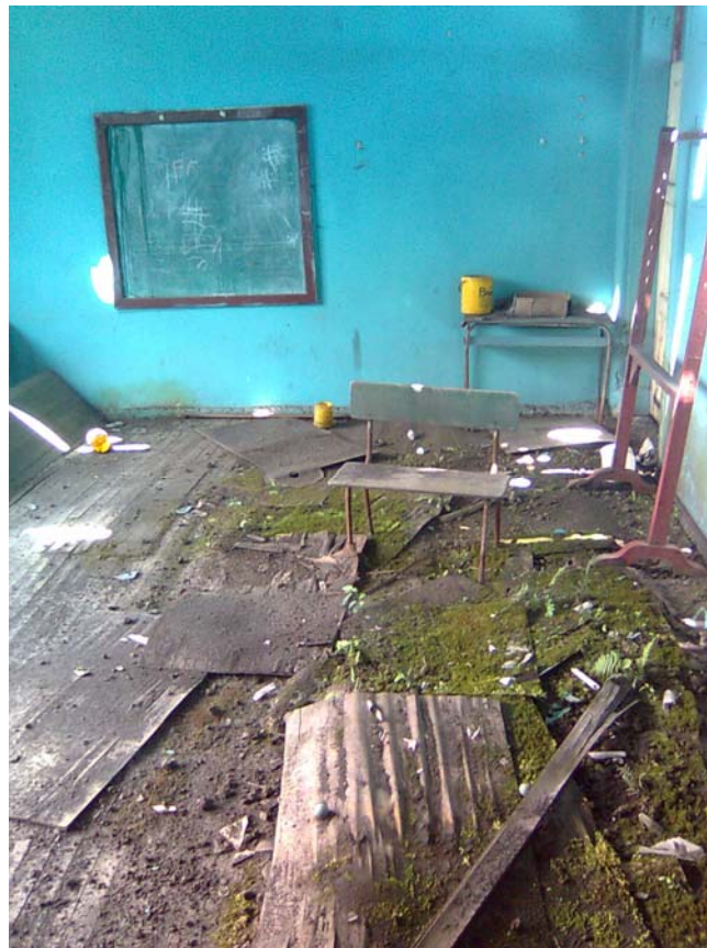
Condiciones del piso, debido al ingreso de lluvias por la destrucción del techo
