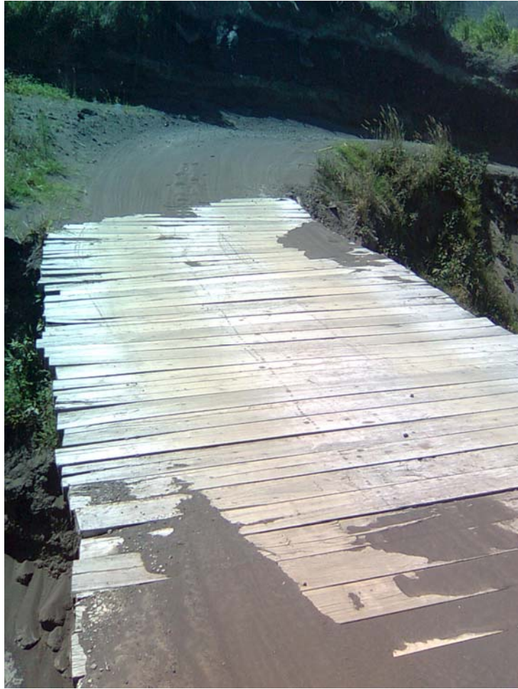
Puente sobre quebrada La Hacienda, fuente de peligro constante para los habitantes de Cusua
