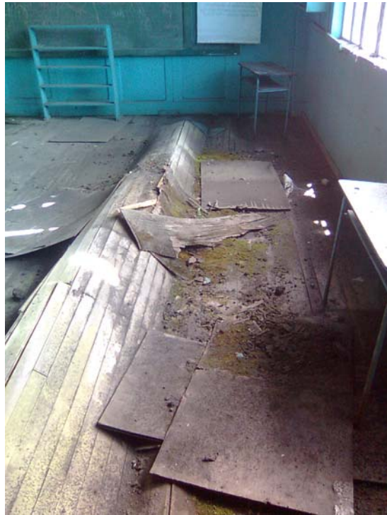
Otra vista de la destrucción del piso
