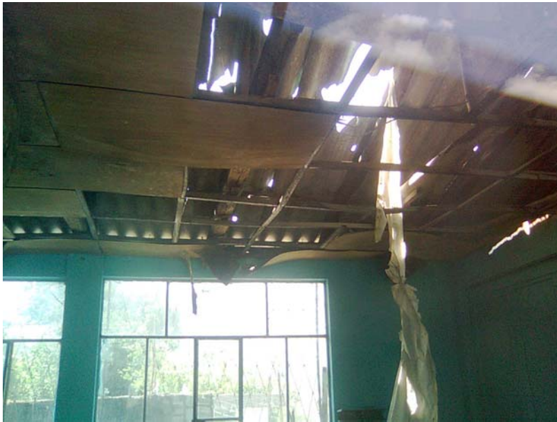
Destrucción del techo de la escuela
