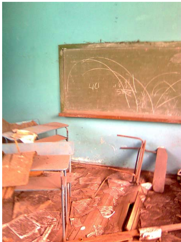
Destrucción del mobiliario escolar por la acción de las lluvias
